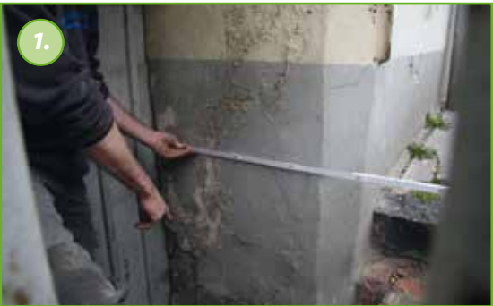
Het handelt zich hier om een tot 80 cm dikke muur uit het jaar 1750 Het stuc en schilderwerk is beschadigd. De zout en vochtwaarden van de steen zijn hoog.
